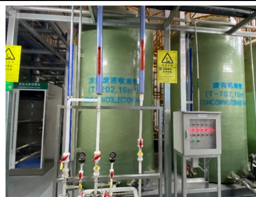
废液储存罐区（浓氟废液、有机废液）
