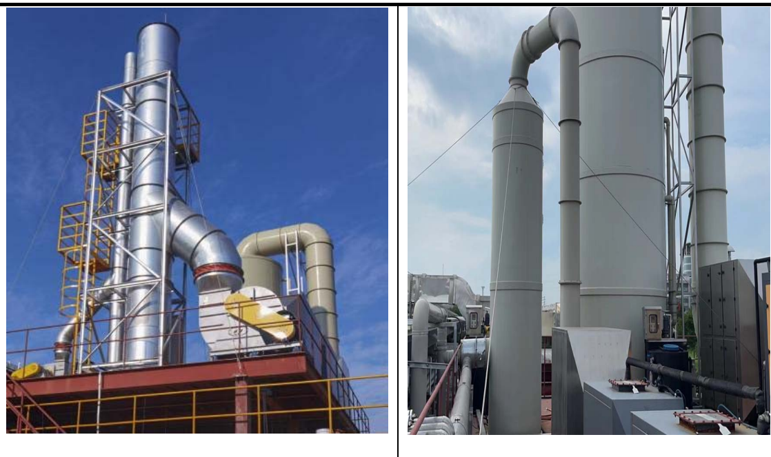
废气处理设施照片
