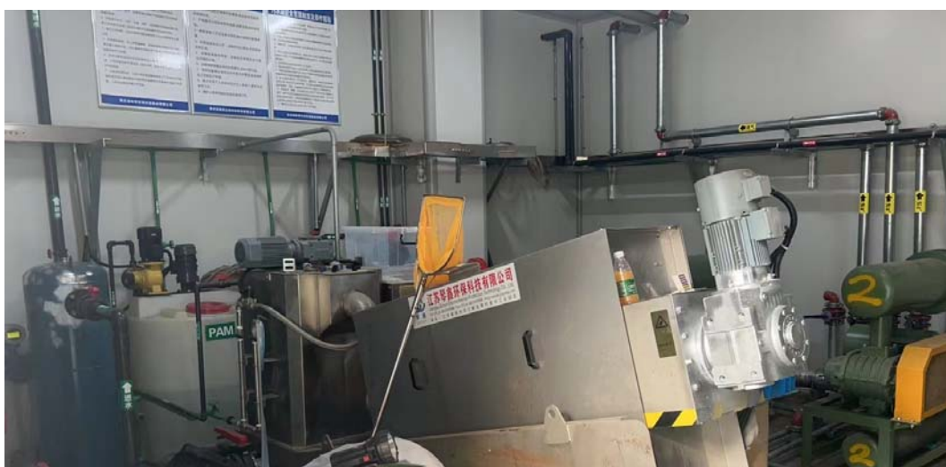
污水处理设施照片
