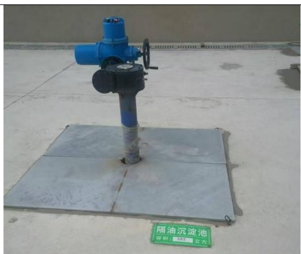
含油废水处理设施
