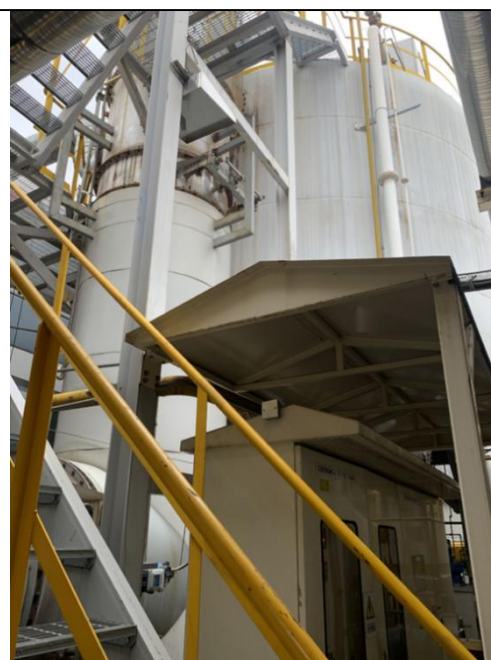
RTO燃烧装置
