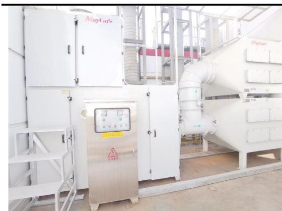
“初中效板式过滤器+静电吸附+UV光解+活性炭吸附”装置
