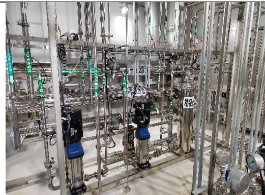
纯化水制备装置
