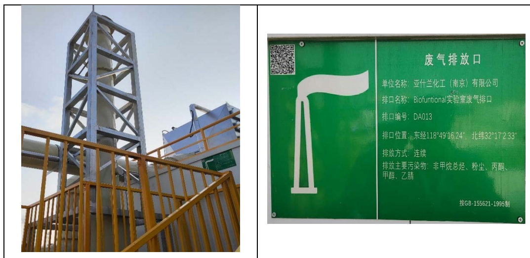
图 3-5 本项目新建排气筒及标识牌
