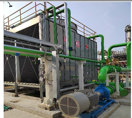
循环冷却水装置
