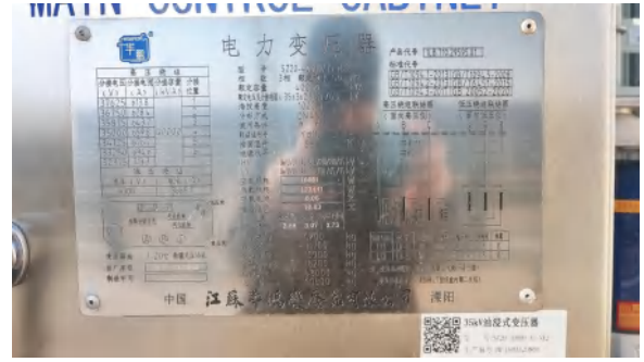
35kV #5 主变铭牌
